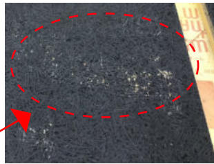
※ 部分的な塗装の剥がれ
